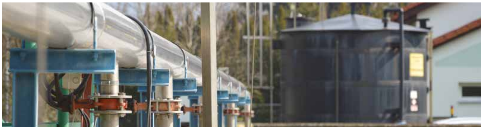
ČOV Valašské Meziříčí
