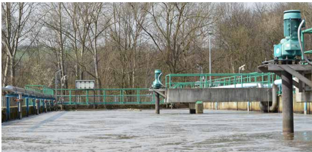
Čistírna odpadních vod Valašské Meziříčí
