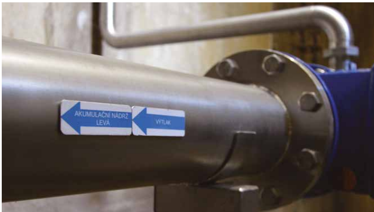
Armaturní komora vodojem Zašová pro horní tlakové pásmo
