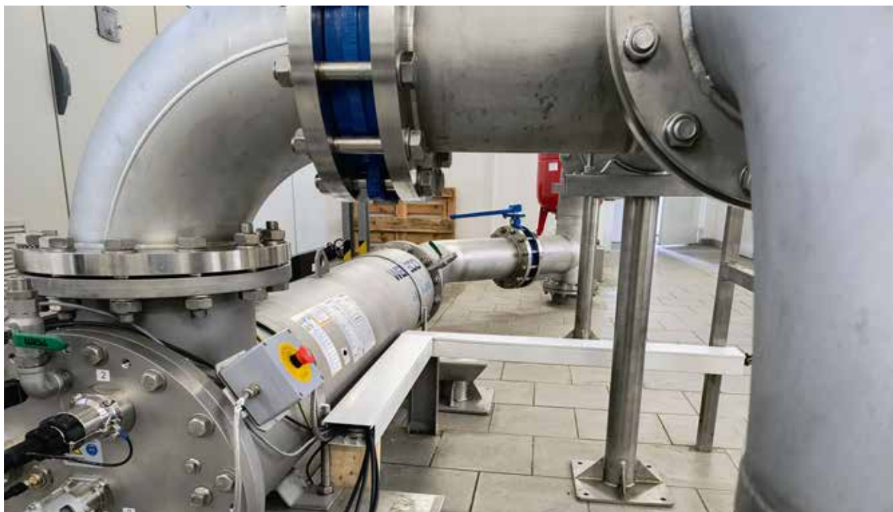
Čerpací stanice Vsetín - Ohrada - výměna ultrafialových lamp pro desinfekci vody
