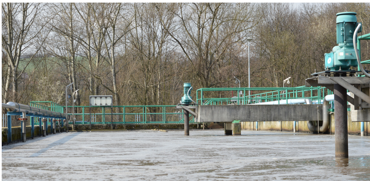
Čistírna odpadních vod Valašské Meziříčí
