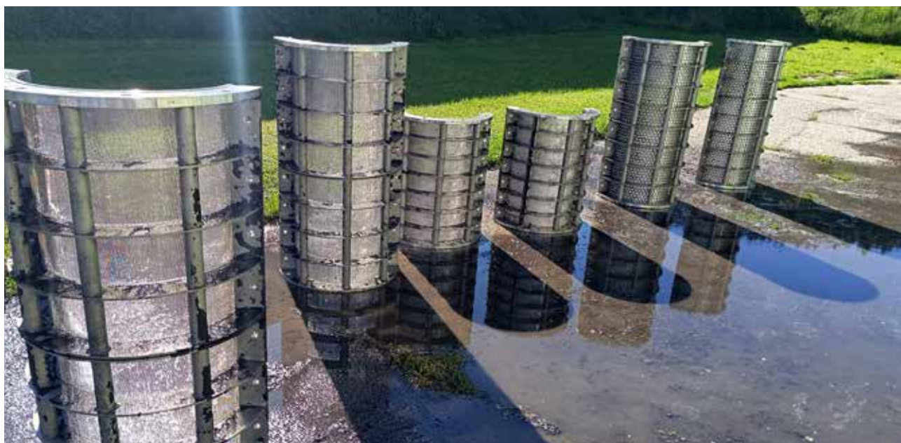
Čistírna odpadních vod Vsetín - čištění šnekolisu
