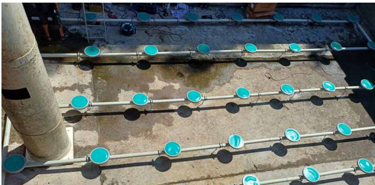
Čistírna odpadních vod Kelč - nové provzdušnění
